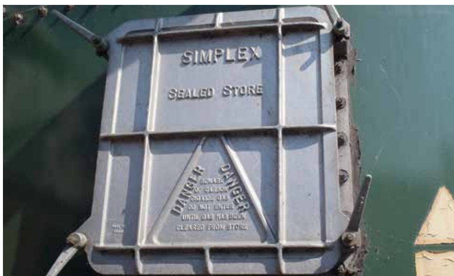
Mandeluge på gastæt silo med advarsel om CO 2 -gas og påbud om at tilføre ilt før man går ind.
